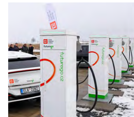
Dobíjecí hub v Tuchoměřicích, jehož součástí je i 1000. veřejná dobíjecí stanice pro elektroauta v síti ČEZ
